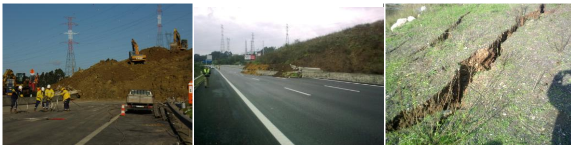
Figura 3 - Movimento de terrenos na A9/CREL (km 9,6 sentido Estádio Nacional – Alverca) 8
