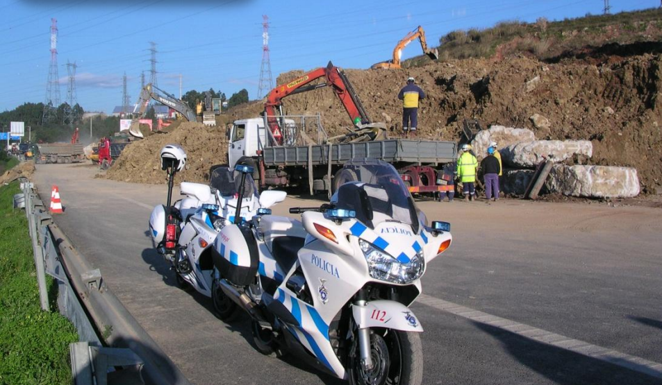
DESASTRES NATURAIS DESLIZAMENTO 22JAN2010
